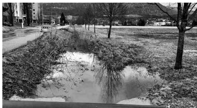
Brühlgraben, die Ableitung des Wassers muss durch einen sachgerechten Unterhalt gewährleistet werden; Foto BSB Ingenieure AG
